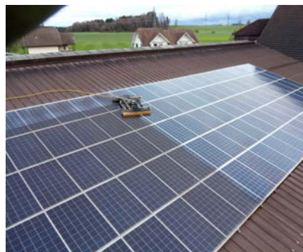
Die Reinigung der Solaranlagen erledigt ein Putzroboter.
